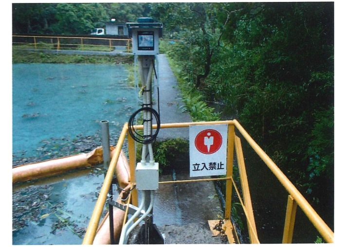
写真5.2.5.3 放流水用pH計の設置状態
